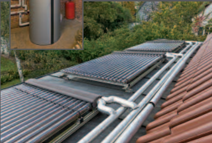
Thermische Solaranlage mit Röhrenkollektoren
