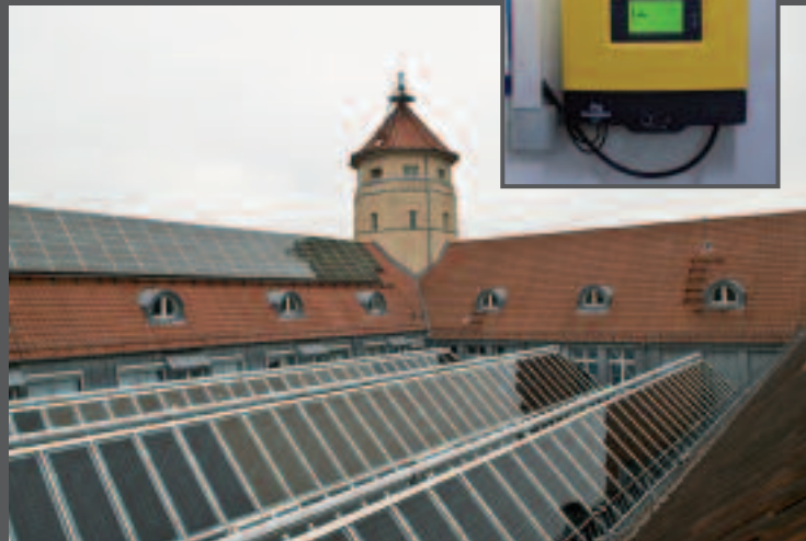
Photovoltaik auf Sheddach im Innenhof
