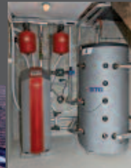
Wärmepumpe mit Warmwasserspeicher
