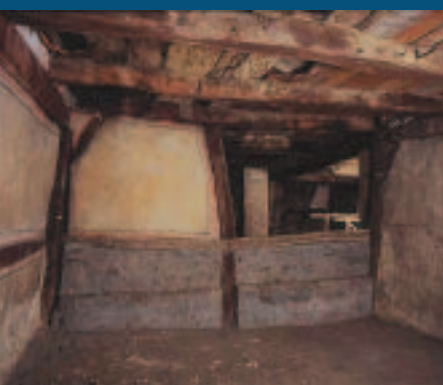
Kammer im Obergeschoss, 2004 Die Kammer vor der Sanie- rung. Ein Fachwerkkfeld zur zweigeschossigen Küche fehlt und gibt den Blick frei auf das ursprüngliche Rauchabzugsloch und den neuzeitlichen Kamin. Der Fußboden besteht aus einem Kalkestrich.
