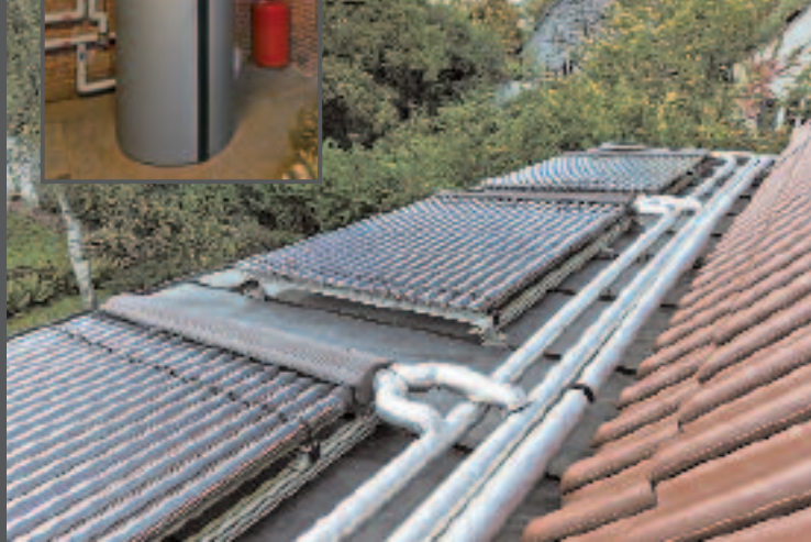
Thermische Solaranlage mit Röhrenkollektoren
