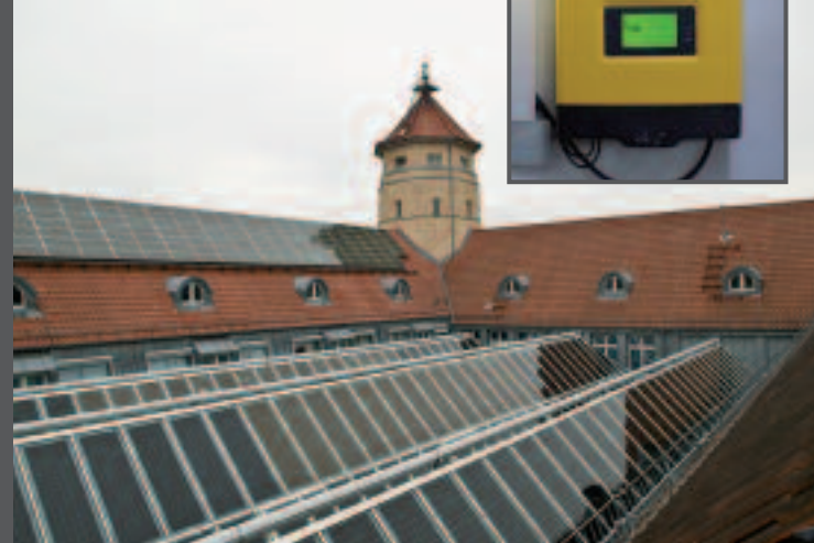
Photovoltaik auf Sheddach im Innenhof
