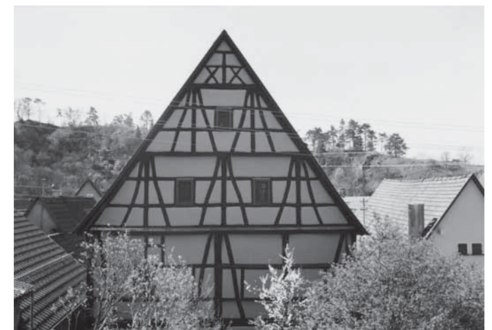
10 Veringenstadt, Rathaus. Blick auf die nördliche Giebelseite. Das aus der Bauzeit um das Jahr 1503 stammende Fachwerk des zweiten Obergeschosses sowie des ersten und zweiten Dachgeschosses weist verzapfte Aussteifungselemente auf, wie sie in ihrer gebogenen Form für das 16. Jahrhundert typisch werden. Der Giebelspitz mit seinen Rautenkreuzen geht auf eine nachmittelalterliche Veränderung zurück.
