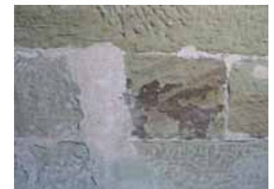
4 Zentral die Vermörtelung der Einarbeitung (Befund 3); Unten rechts die Abarbeitung des Sockels, oben rechts die jüngeren Spitz Eisenspuren
