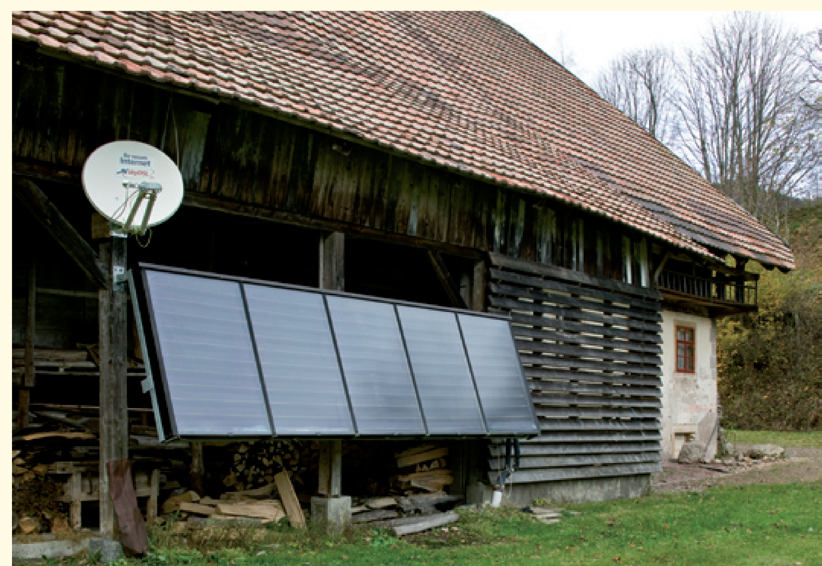
Thermische Solaranlage am Ökonomieteil
