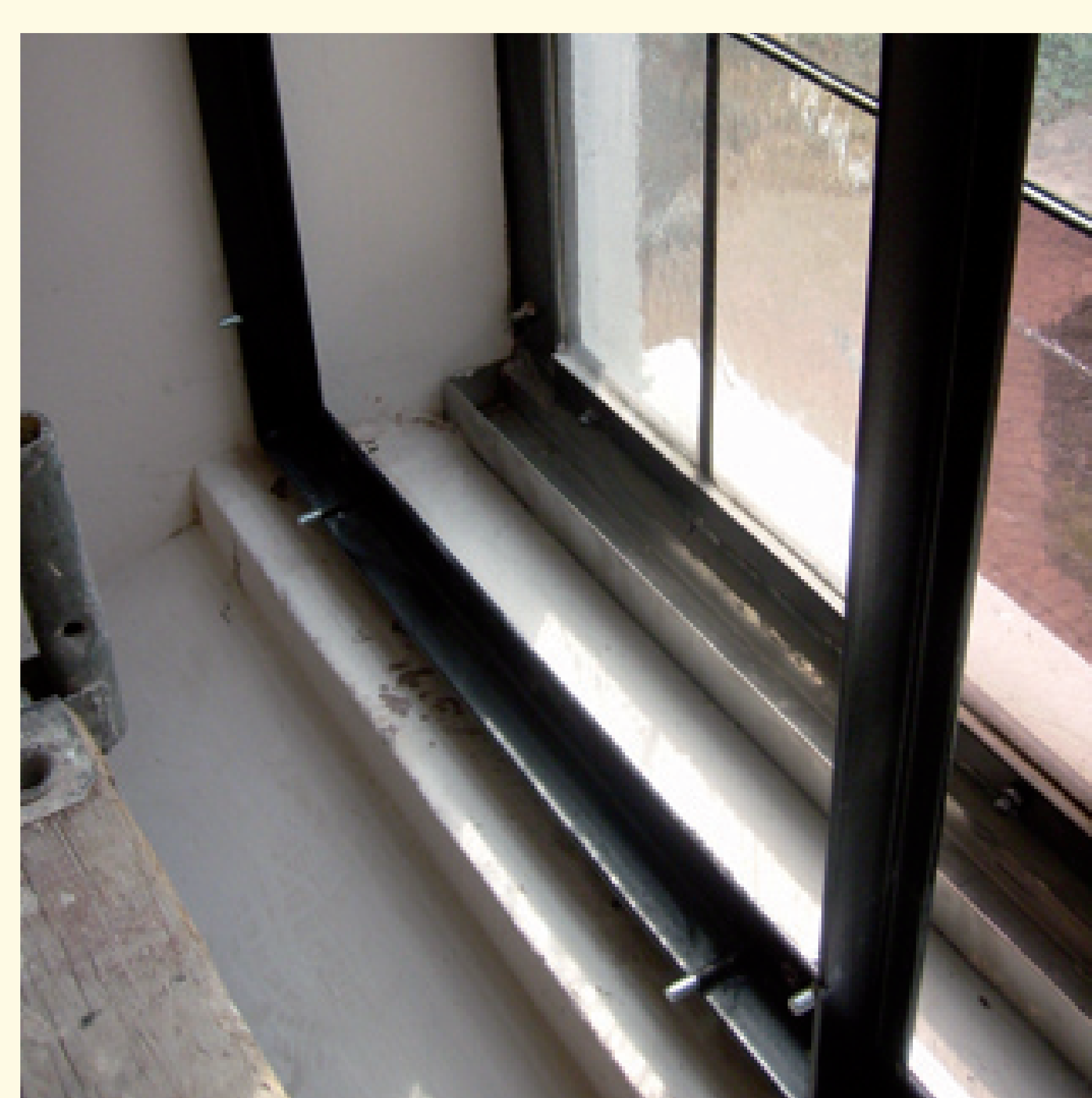
Luftkollektoren in den Kirchenfenstern
