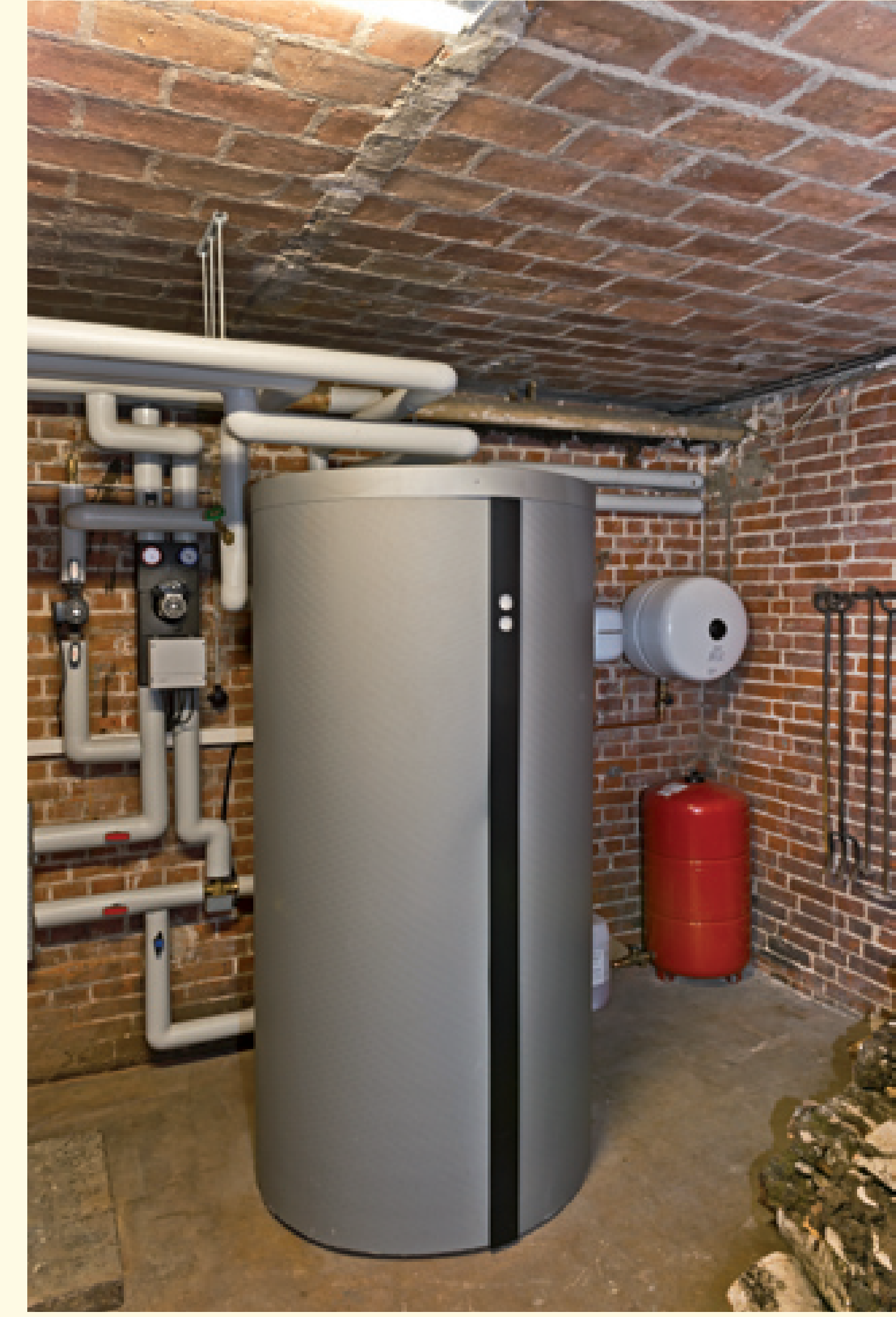
Warmwasserspeicher im Kellergeschoss
