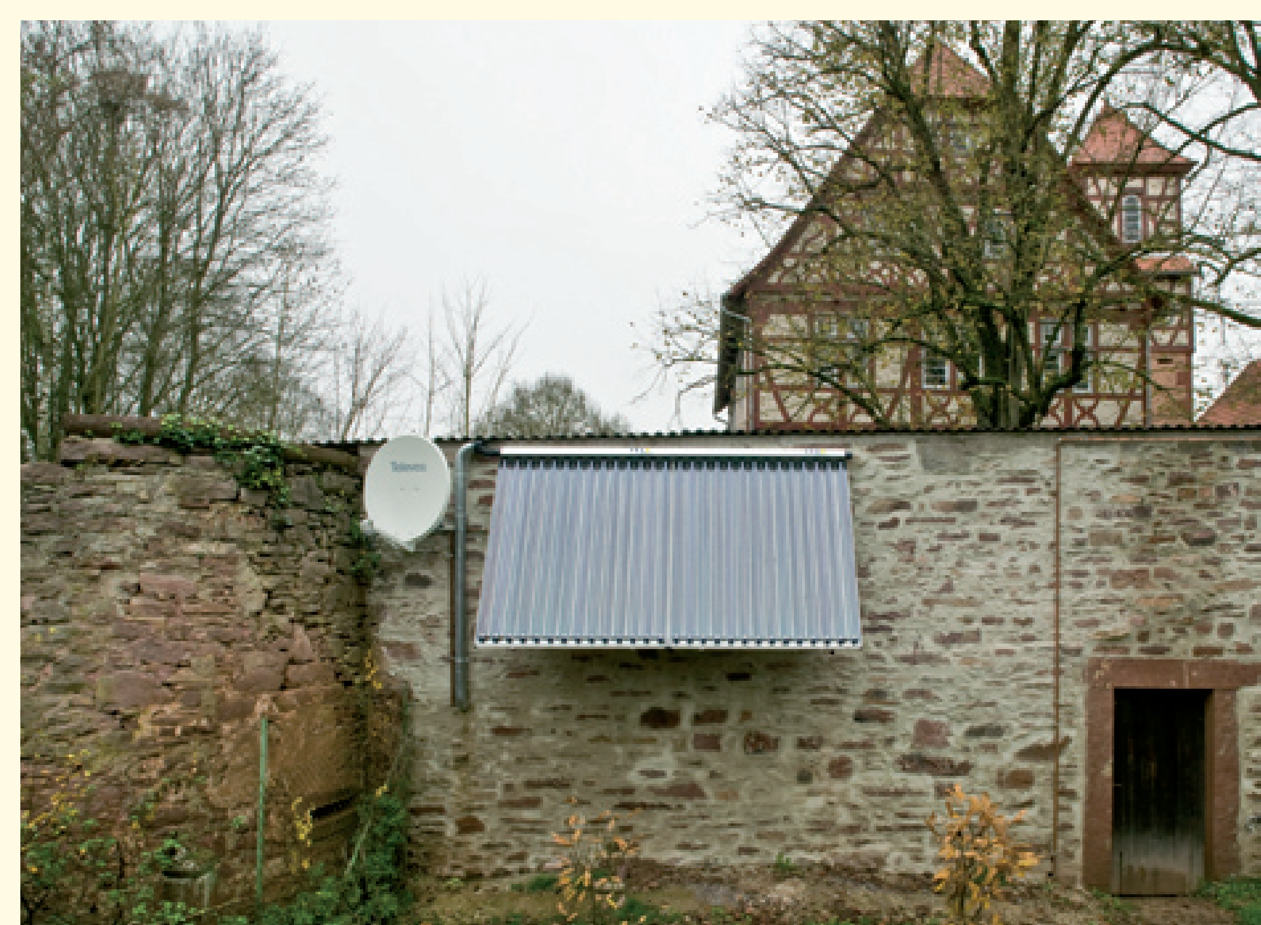
Vakuumröhrenkollektor auf der Einfriedung in einem öffentlich nicht zugänglichen Bereich
