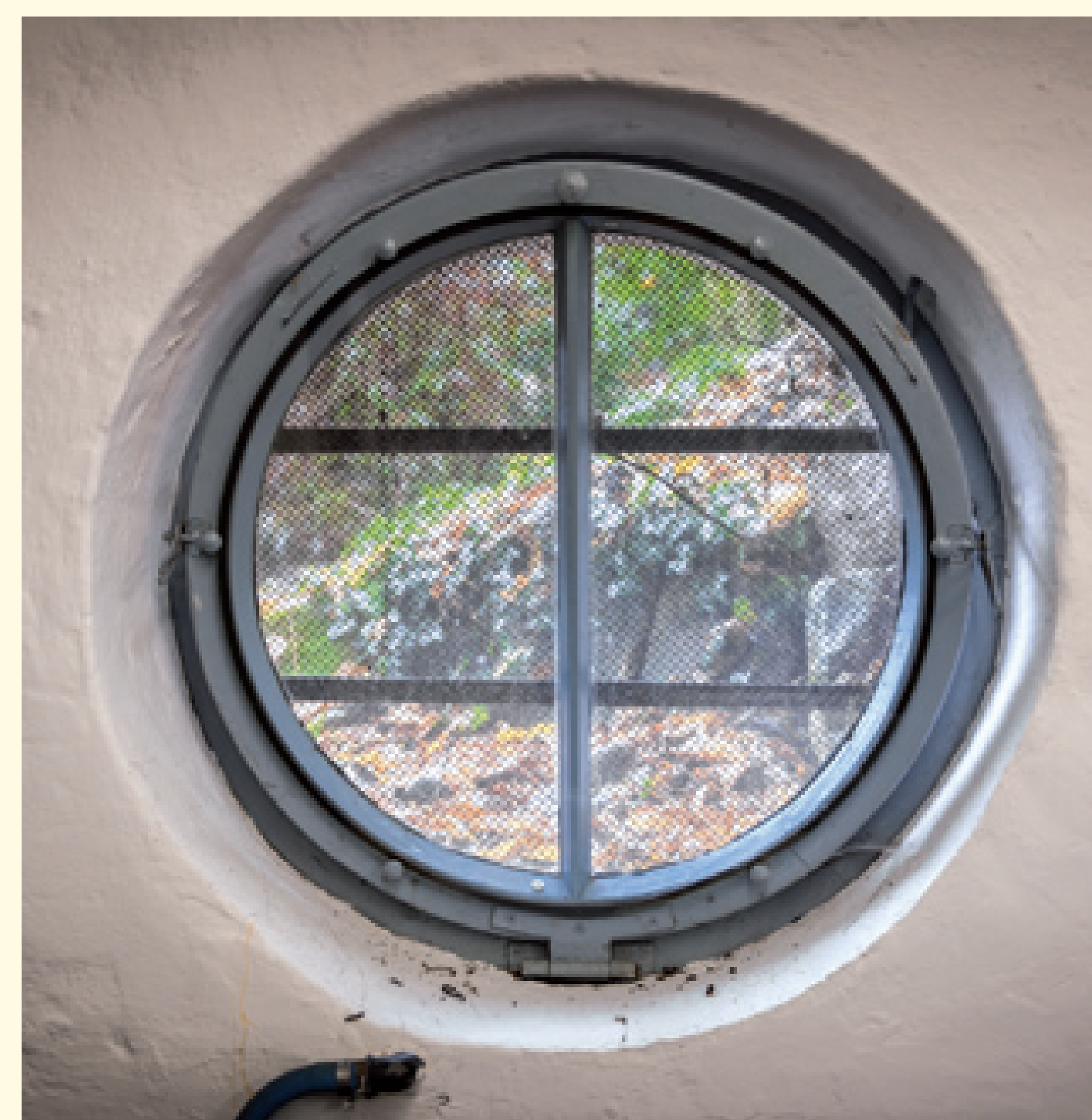
Technische Verbesserung der bauzeitlichen Fenster durch Aufbringen einer Vorsatzscheibe. Fenster im Heizungskeller.
