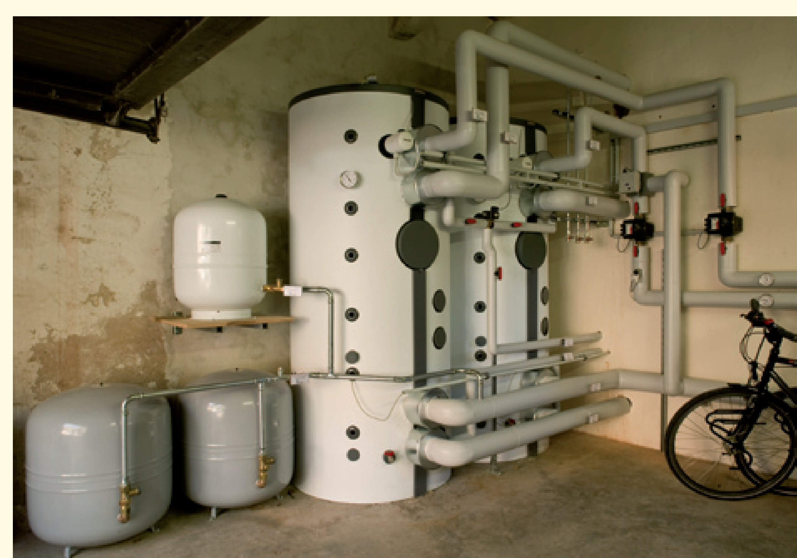
Haustechnik im Nebengebäude
