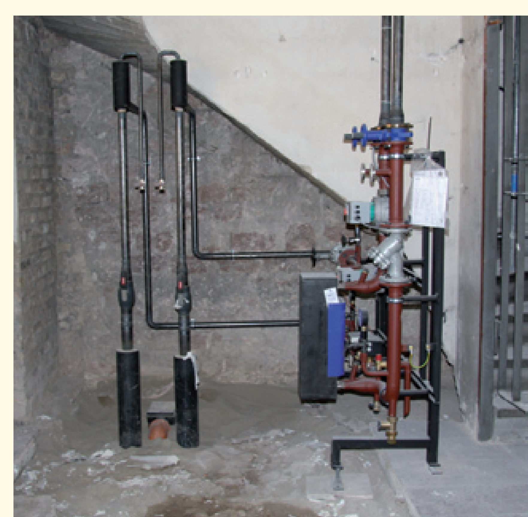
Fernwärmeübergabe unter der Empore
