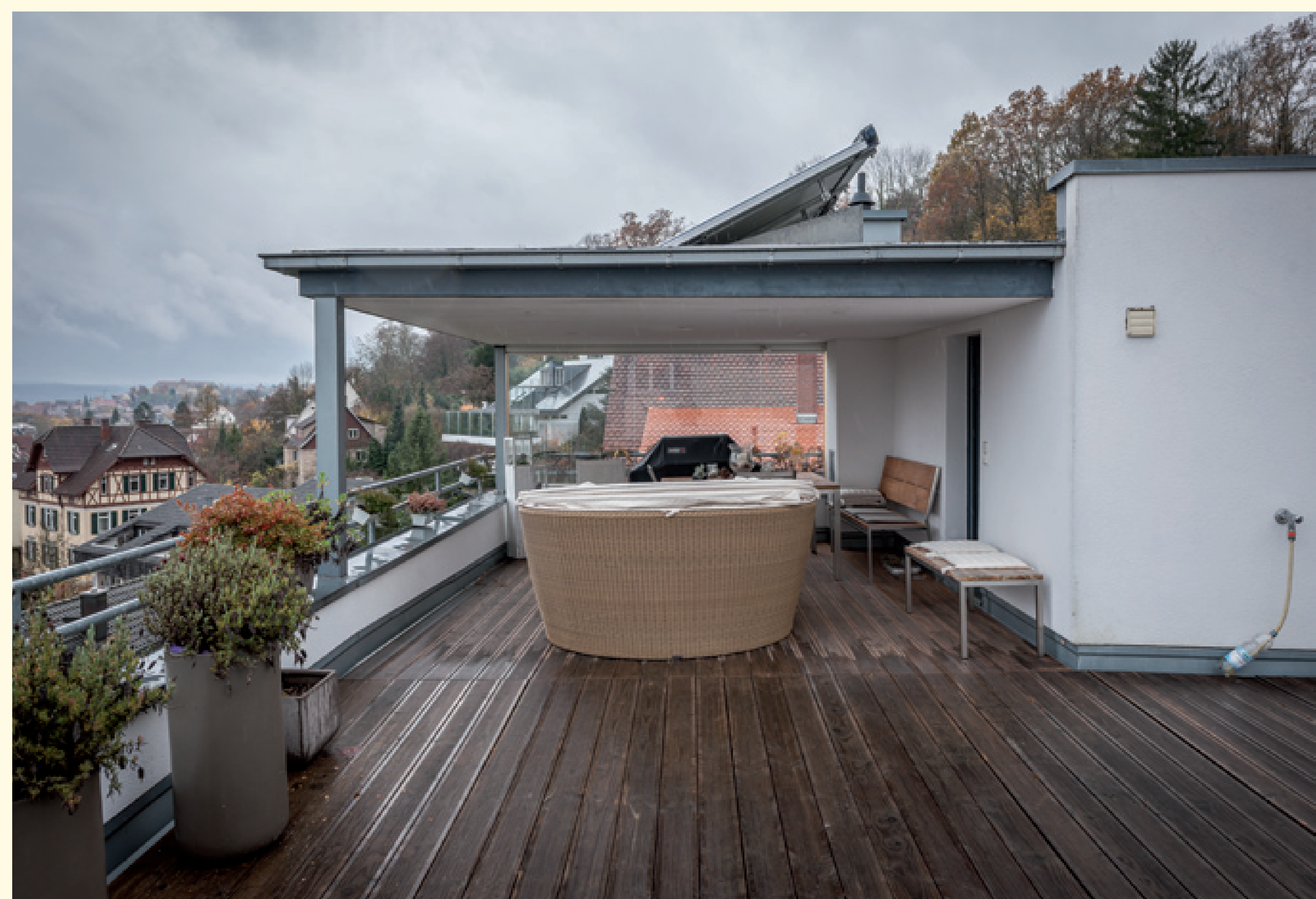
Flachdach der rekonstruierten Dachterrasse mit Vakuum-Röhrenkollektor
