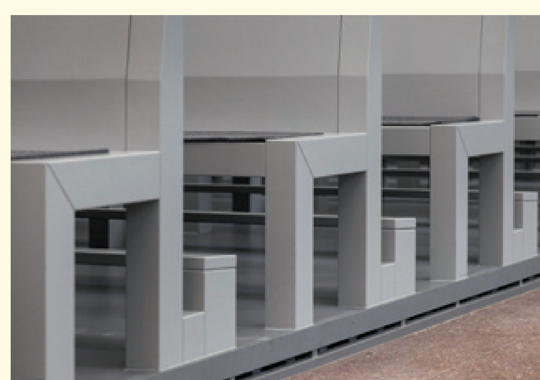
Die Warmluft wird unter das Bankpodest geführt und von dort in die Gänge ausgeblasen
