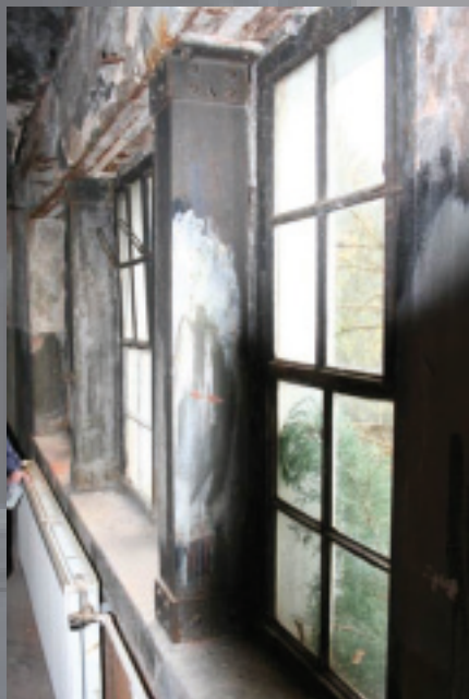
Die gusseisernen bauzeitlichen Fenster eines Heizhauses wurden im Zuge der Umnutzung zum Wohnhaus bautechnisch ertüchtigt und energetisch verbessert. Dies gelang durch eine zusätzliche Fensterebene innen. Die neuen Fenster wurden in die Dämmebene der neuen Innendämmung aufgenommen.
