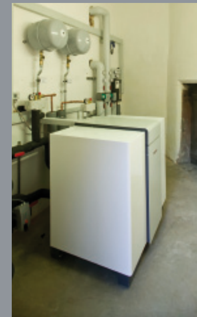
In der Modernisierung der Haustechnik liegt ein großes Effizienzpotenzial
