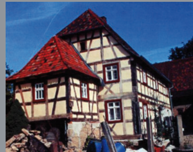
Fachwerkhaus mit Lehmgefachen, Lehmminendämmung, Fensterreparatur und Ergänzung zum Kastenfenster, sowie erneuerter Heizungsanlage
