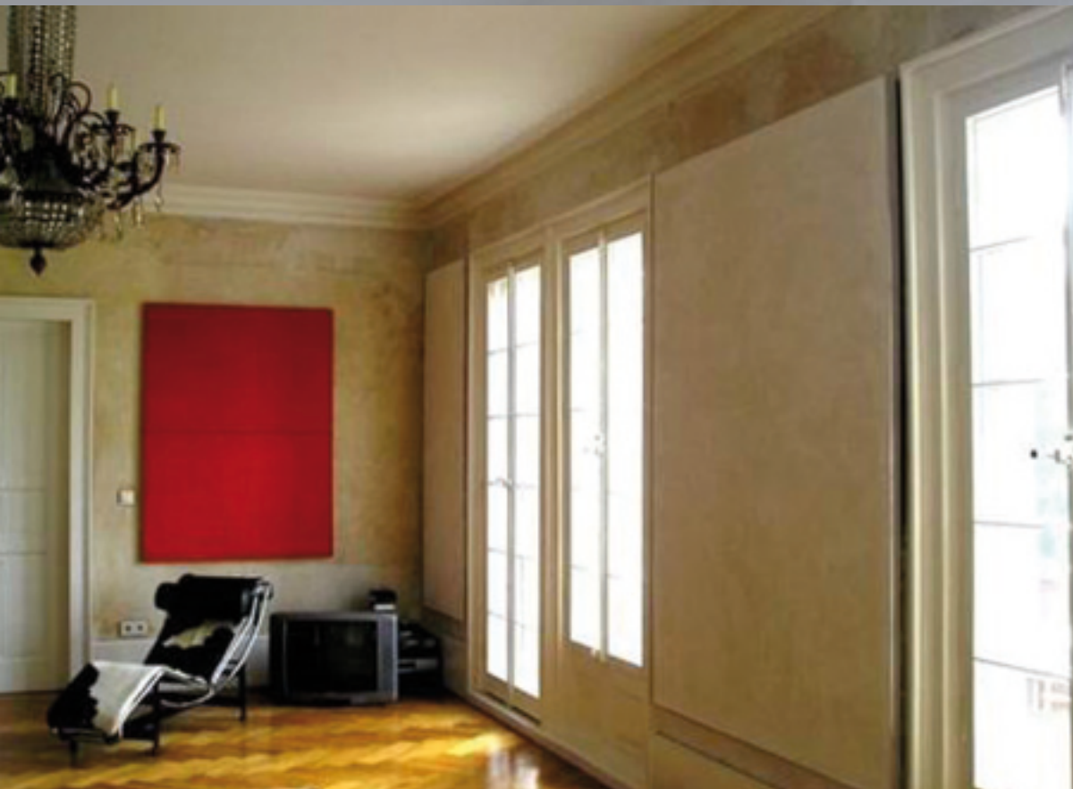
Im Bereich der Haustechnik sind im Denkmalumgang kreative Lösungen gefragt, die sich mit dem Bestand auseinandersetzen. Außenwandheizung in Gestalt eines gerahmten Gemäldes
