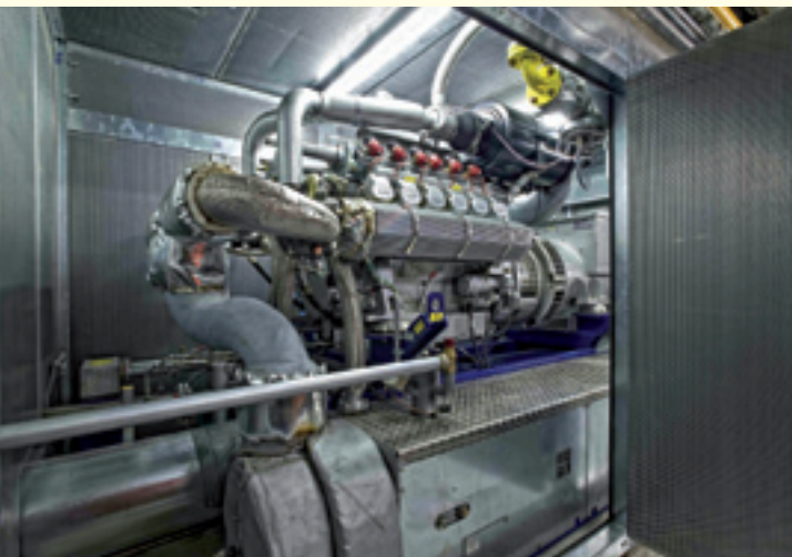
Blockheizkraftwerk des Landeskriminalamts Baden-Württemberg in seiner Einhausung
