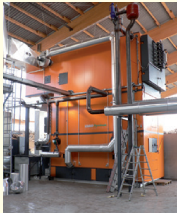
Holzhackschnitzel und Holzhackschnitzelheizung
