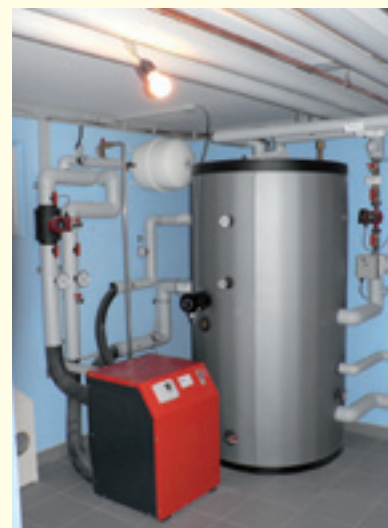
Wärmepumpe und Warmwasserspeicher für ein Wohnhaus
