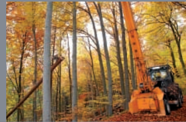
Ein Kurzstreckenseilkran im Einsatz: Durch den schwebenden Transport werden Schleifspuren bzw. Schäden im Boden vermieden.
