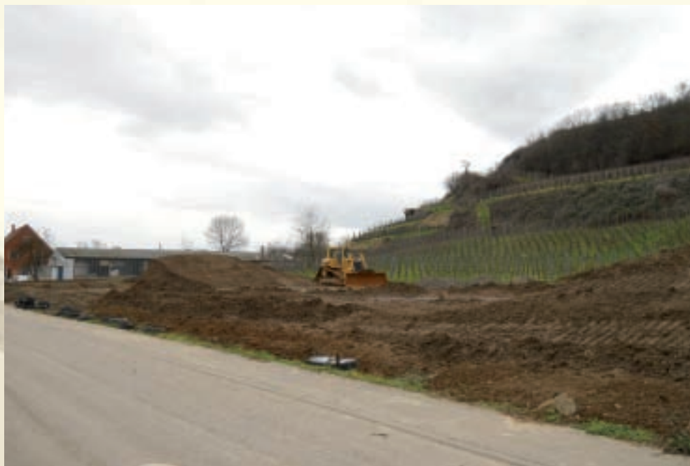
Überschüttung der zu schützenden Flächen im Kernbereich des frühmittelalterlichen Gräberfelds in Sasbach am Kaiserstuhl. Bei solch einem Vorhaben muss eine Abwägung im Hinblick auf Auftragshöhen, Oberbodenabtrag und Dokumentationsstand des Kulturdenkmals erfolgen.
