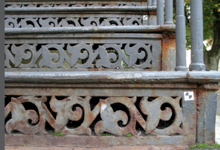
Detail der gusseisernen Treppe vom Verwaltungsgebäude der Schwäbischen Hüttenwerken in Königsbronn. Zahlreiche Schäden entstehen im Winter durch die Aufbringung von Streusalz. Die Treppe wurde in den 1970er Jahren metallisch blank gestrahlt und anschließend verzinkt, was zu zusätzlichen Schäden an der Konstruktion führte.
