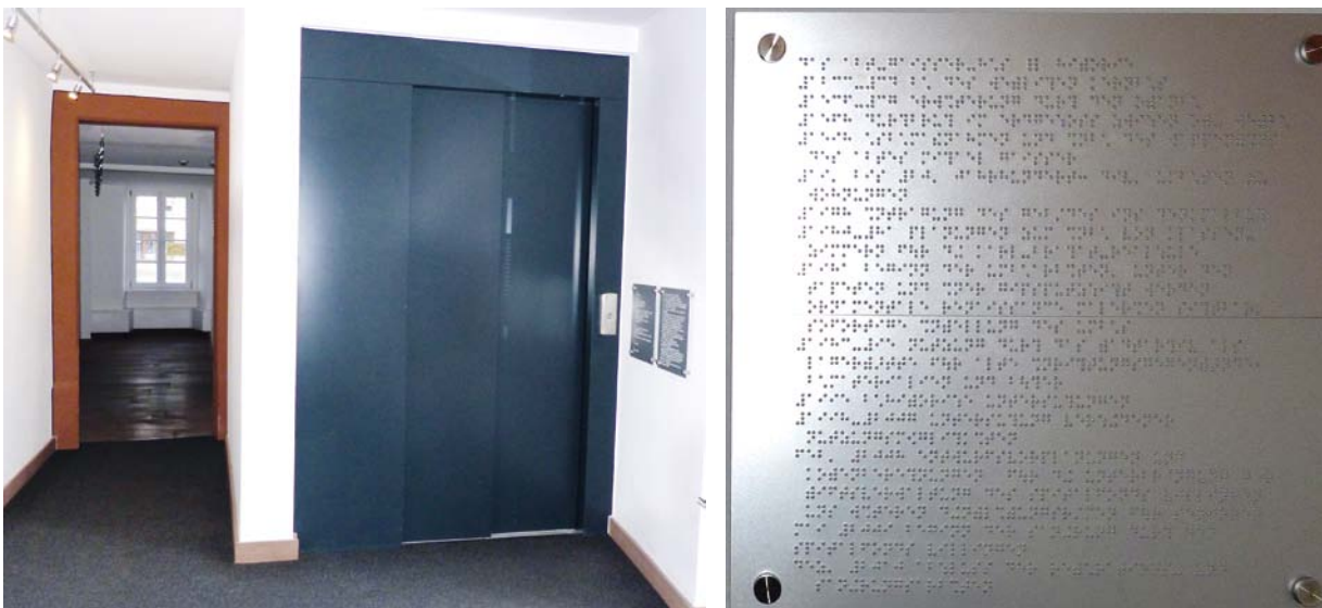
Abb. 107 Eingangsbereich mit Aufzug. Die barrierefreie Erschließung der einzelnen Geschosse ist gegeben, jedoch ist der Aufzugtaster (außen) für Menschen im Rollstuhl schwer oder gar nicht erreichbar. Eine seitliche Anbringung 50 cm von der Wand entfernt wäre eine barrierefreie Konzeption.
