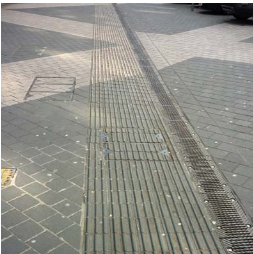
Abb. 22 Taktile Bodenstrukturen kreuzen die gemusterte Pflasterung eines öffentlichen Platzes in London (GB). Die strukturierten Platten sind in ihrer Farbigkeit dem Belag angepasst. Damit konnte das Erscheinungsbild der Fläche gewahrt bleiben. Diesem denkmalfachlichen Anspruch steht die Notwendigkeit einer kontrastreichen Ausbildung solcher Leitelemente Bodenbelag gegenüber. So bleibt im Einzelfall abzuwägen, welchem Belang man Vorrang einräumt. Die Lösung entspricht nicht der DIN, da die Kontraste gering sind.
