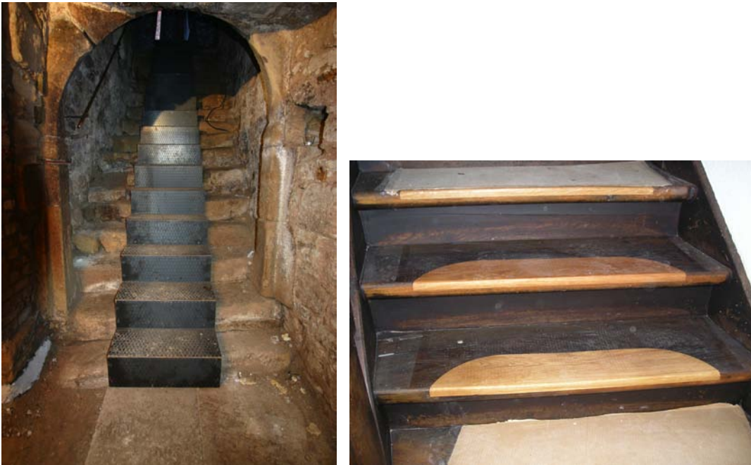
Abb. 64 (oben links) Sofern die Treppe mit ihren Altersspuren erhalten werden soll, eine Reparatur gestalterisch nicht gewünscht oder aus wirtschaftlichen Überlegungen nicht möglich ist, kann auch eine „Überbauung“ der bestehenden Stufen durch eine neue Laufebene als Konzept in Frage kommen. Je nach Raumnutzung sind auch die Anforderungen der Barrierefreiheit einzuhalten.
