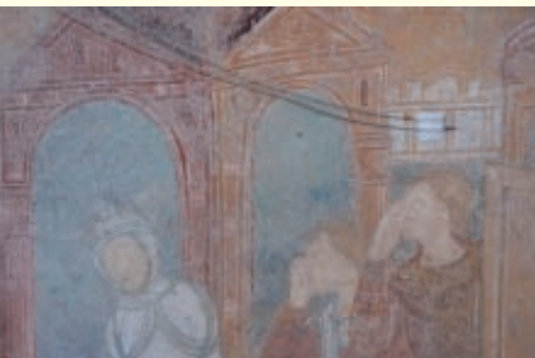
Mittelschiff, Südwand, Messsonde, Auferweckung des Lazarus, rechts Detail.
