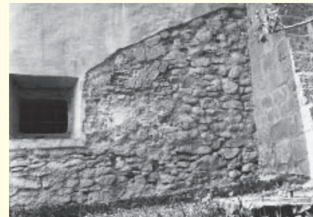
Außenansicht von Norden mit Blick auf den nördlichen Keller nach Abnahme des Außenputzes von 1951/52 im Sockelbereich und im Anschluss an den östlichen Stützpfeiler. Es gibt deutliche Störungen im Mauerwerk.
