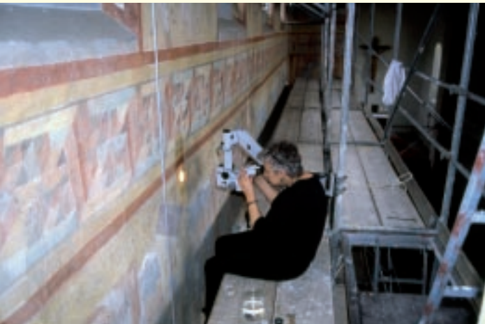
Mikroskopische Untersuchung der Wandmalerei während der Abnahme des Schimmelbefalls 2003.
