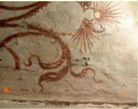
Malerei im Brunnenhausgewölbe, Detail. Zustand vor der Malschichtfestigung.
