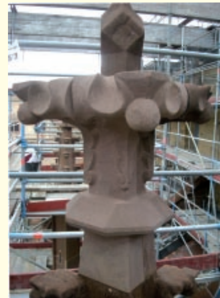
Die Instandsetzung der Sandsteinfassade beinhaltet im Einzelfall den ganzen oder teilweisen Ersatz von Werksteinen, hier das Oberteil einer Fiale. Das Steinmaterial stammt aus Steinbrüchen der näheren Umgebung. Der Erhalt der historischen Bausubstanz hat Vorrang vor rein optischen Mängeln.
