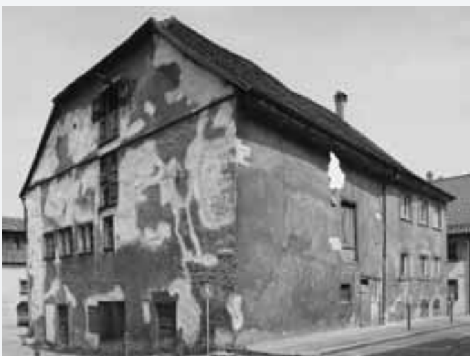
Vom desolaten Zustand des Weberzunftshaus vor Beginn der Sanierung zeugt dieser Blick von Süden aus dem Jahr 1993. Mauerwerk und Holzgefüge wiesen schwere Schäden auf, die besonders die statische Sicherheit beeinträchtigten.
