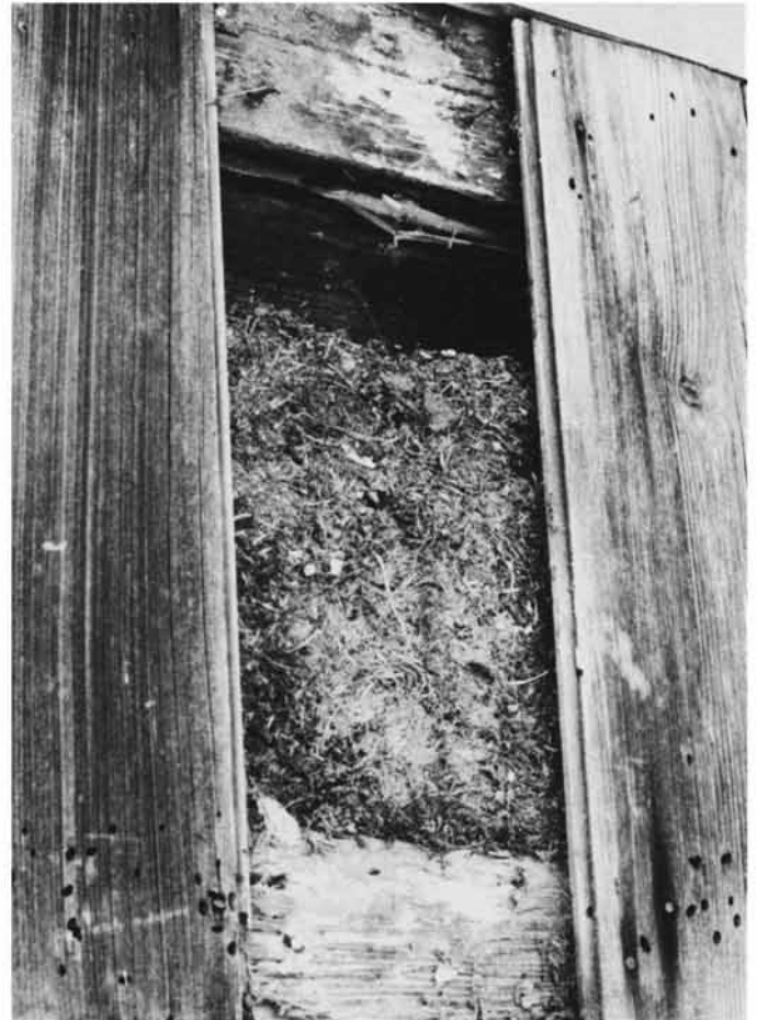
Abb. 286 Nachträglich verschalte Bohlenwand mit Moosfüllung als Wärmedämmung. Unter der Brettschalung zeigt sich ausgeprägter Schädlingbefall. Oberer Geschwendhof.
