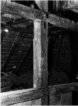
Abb. 200 Stoß an einem reparierten Firstständer. Reinertonishof 1619 in Schönwald.
