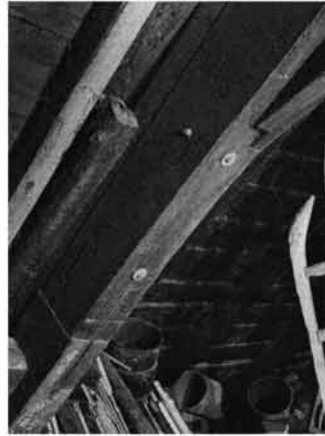
Abb. 201 Reparatur eines Wolfes am Reinertonishof durch stumpfen Stoß in Verbindung mit Stahlplatte und Stabdübeln.
