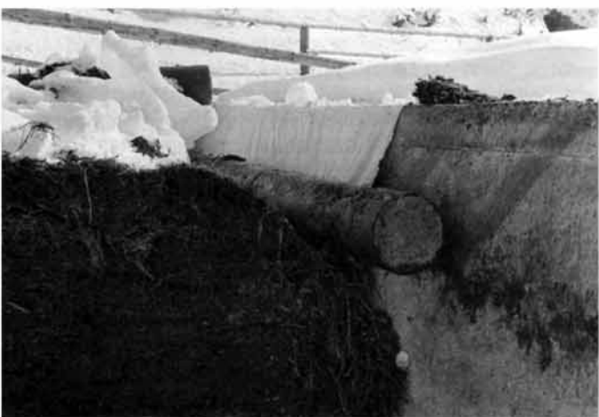
Abb. 136 Seitliche Abdichtung des Fahrsilos durch betongefüllte Rohrstücke.
