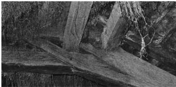
Abb. 147 Verformter Knotenpunkt X (Abb. 146) mit gebrochener Strebe.
