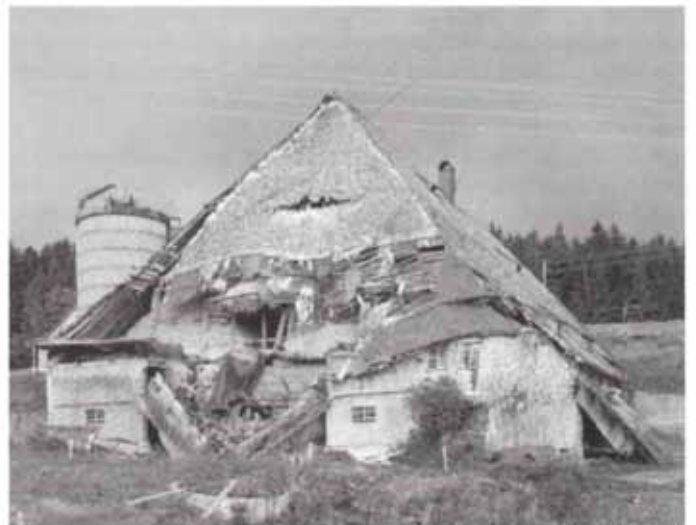
Abb. 154 Der Windschaden an einem Höhenhaus entspricht dem Belastungsbild aus den Windkanalversuchen (Unterlehmannsgrundhof, Güttenbach).
