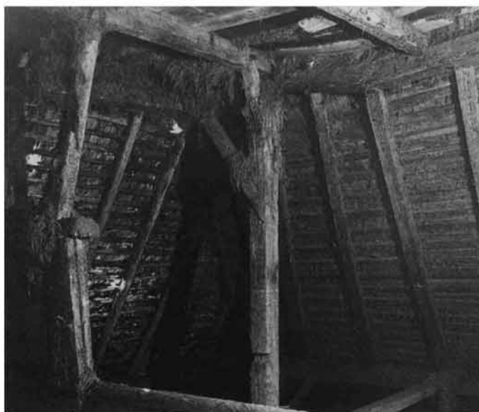
Abb. 417 Talseitige Gebäudeecke mit gebrochener Pfette.
