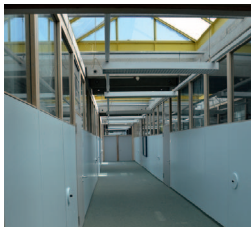
Die Geschwister-Scholl-Schule in Konstanz (1972-1976) setzt zeittypische Forderungen wie Flexibilität und Transparenz architektonisch gelungen um.
