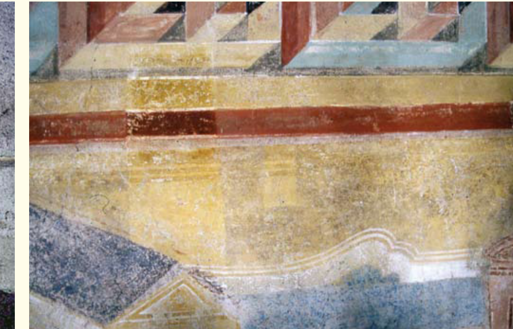
Proben zur Abnahme des Schimmels
