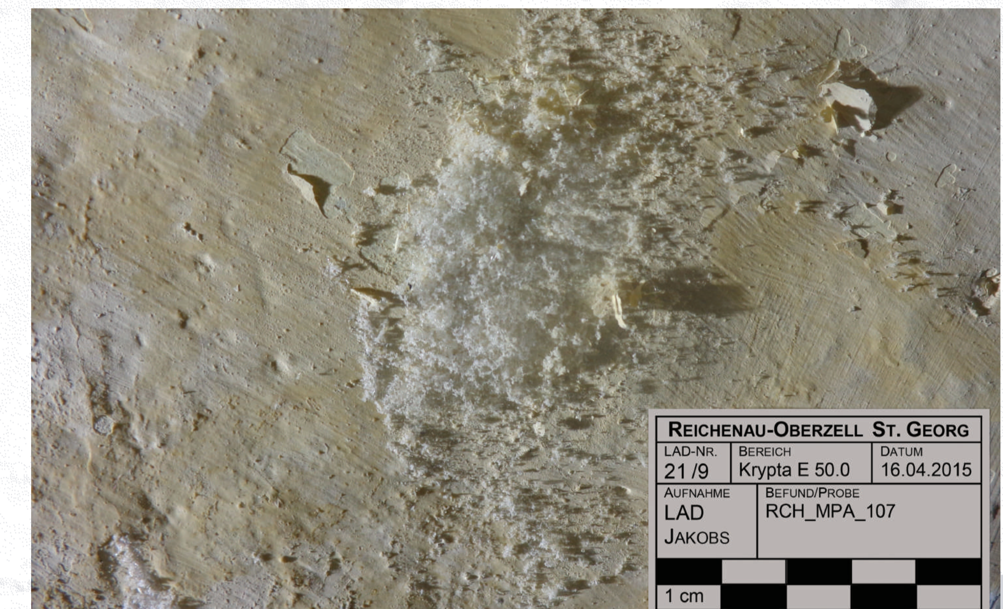
Fleckenbildung, Aufwölbung der Oberfläche mit darunter liegender Salzaakkumulation und Ausbrüche im Altputzbereich an der Ostwand in der Krypta
