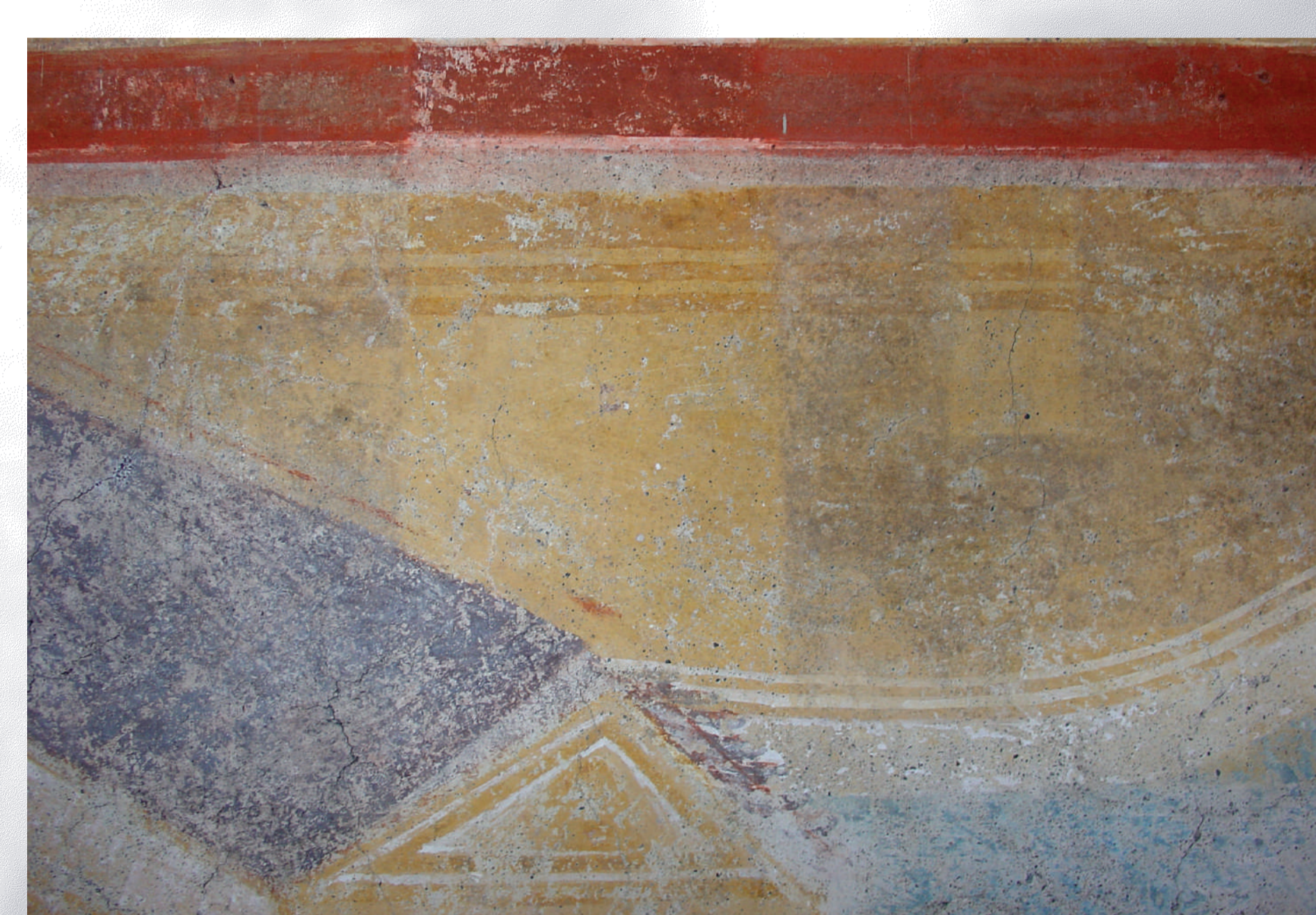
Schimmelpilzbefall auf der Nordwand in der Bildszene der Heilung des Wassersüchtigen im Jahr 2003, Arbeitsproben zur Abnahme Mold infestation on the north wall in 2003, scene 'The Healing of a man with dropsy', work sample of mold removal
