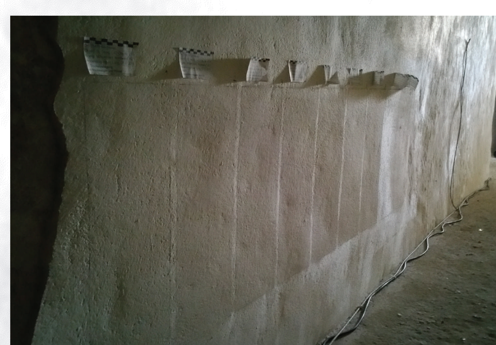
Testfelder unterschiedlicher Behandlungsmethoden gegen mikrobiellen Bewuchs im Gang der Krypta Test fields of different treatment methods against microbial growth in the corridor of the crypt
