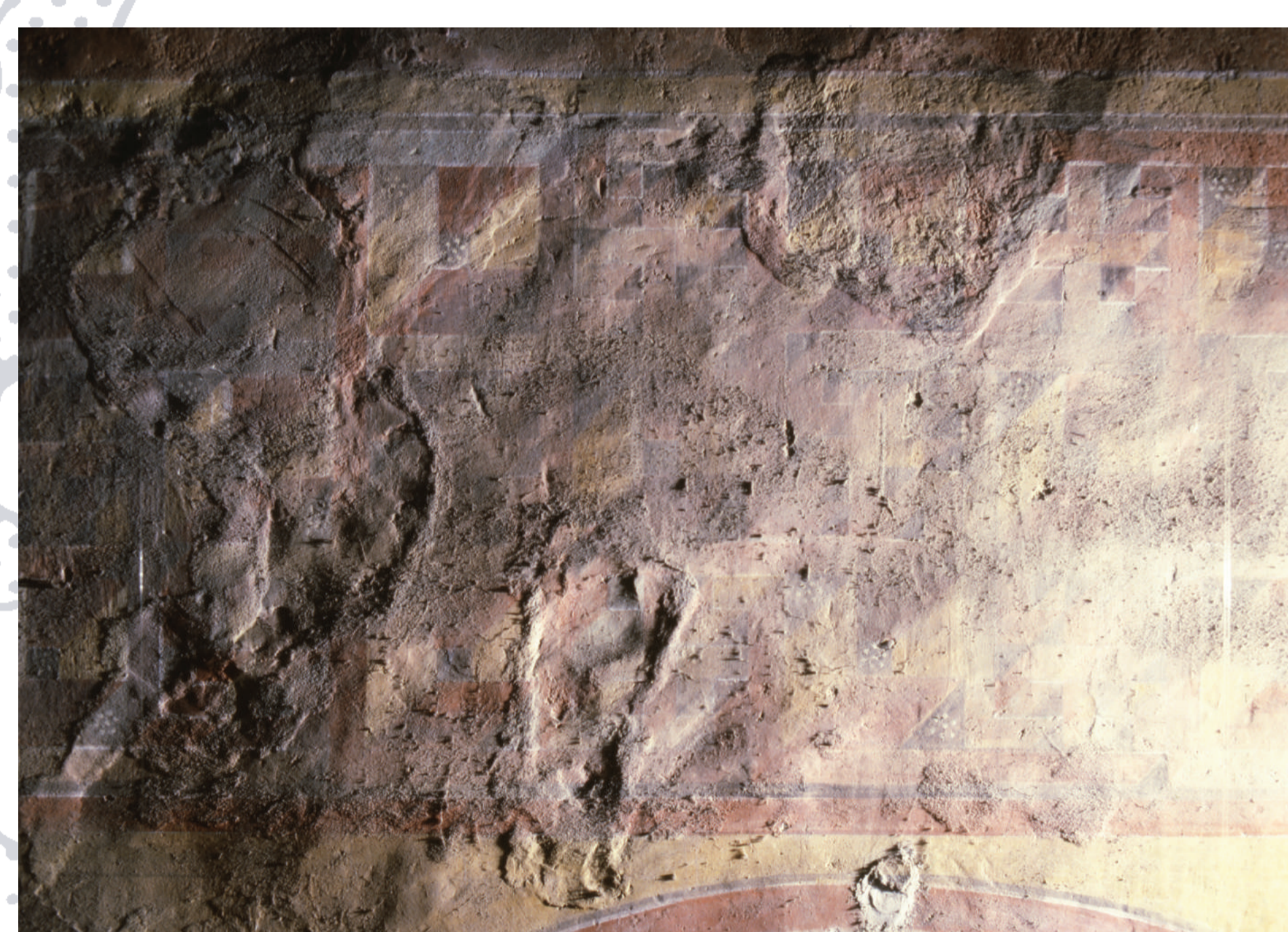
Südwand, Bereich G 7.2.2 / 12 im Streiflicht vor der Restaurierung, deutlich erkennbar die Mörtelergänzungen und Verschmutzungen South wall, area G 7.2.2 / 12, photographed with side lighting prior to the restoration; the additional mortar and dirt clearly visible
