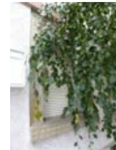
Detail an den Sandsteinsohlbänken an der Frontseite
