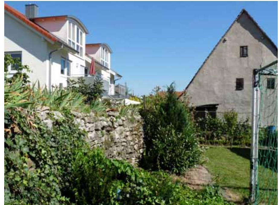
Ettermauer am Grabengartenweg
