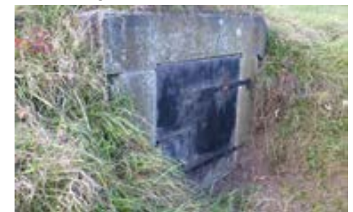
Quelleinfassung auf Höhe Böblinger Straße 22, 2012
