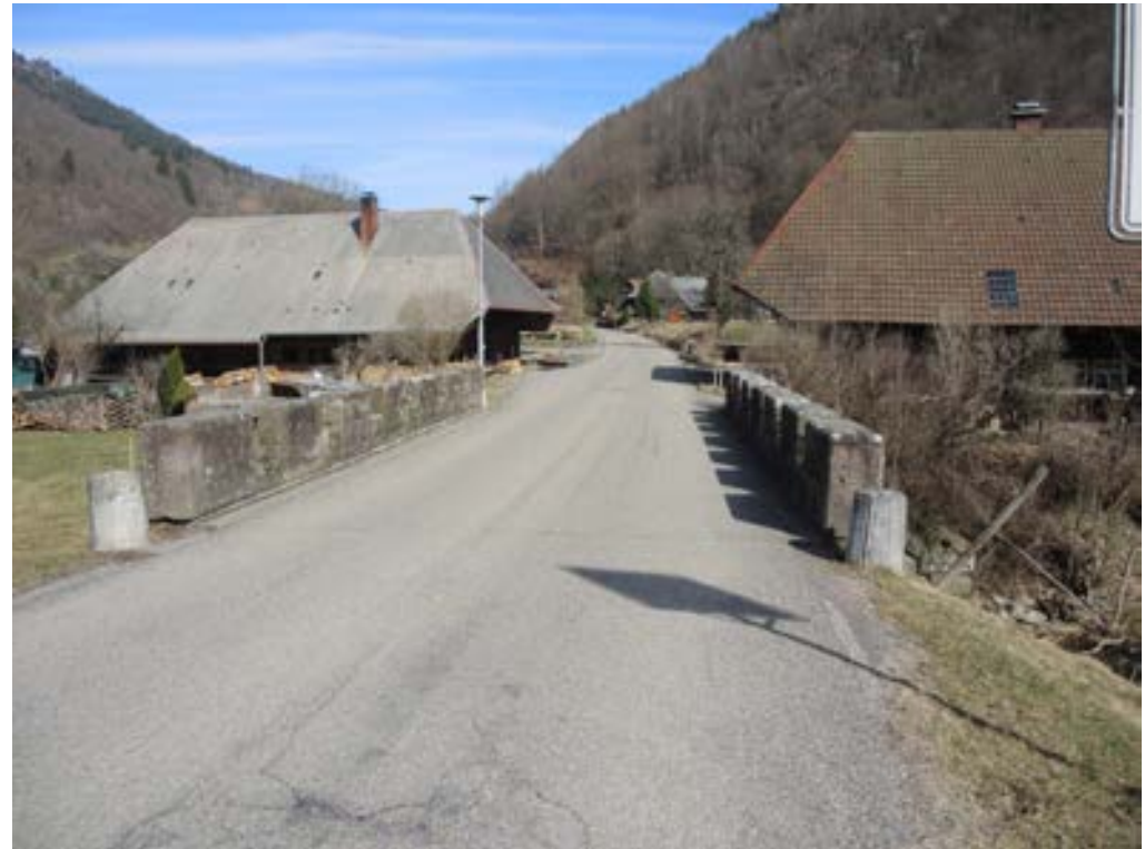
Abb. 6 - Am südlichen Ortseingang des Unterdorfs führt die Mättlestraße über eine den Prägbach überspannende Bogenbrücke (2017)
