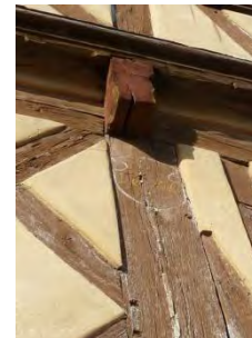
Detail – sichtbarer Balkenkopf mit gekerbter Schwelle und Inschrift
