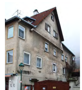
Nordgiebel mit deutlicher Auskrangung ❷
